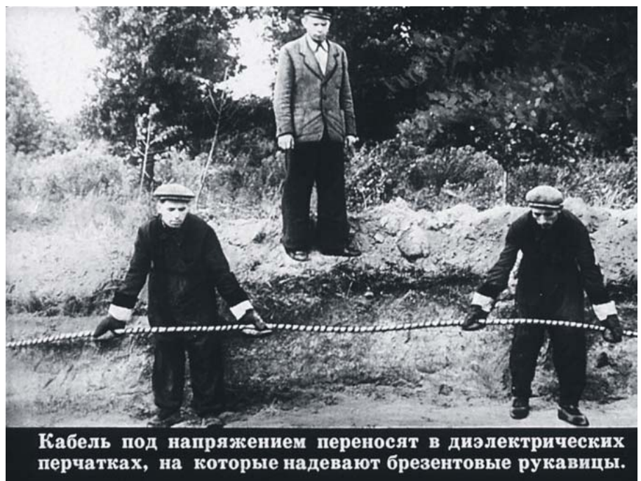
Фото 13. Фрагмент диафильма «Электробезопасность при производстве работ в районах электрических сетей». 1976 год
