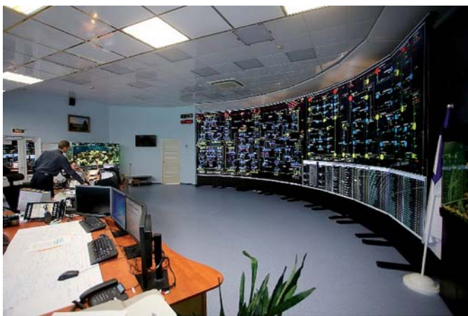
В диспетчерском зале установлен новый диспетчерский щит, позволяющий управлять энергосистемой двух Алтаев. 2017 г.
