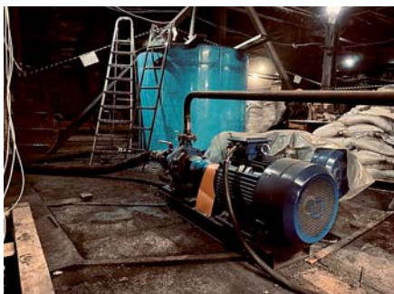
Бак кислотной промывки объёмом 5 м 3
