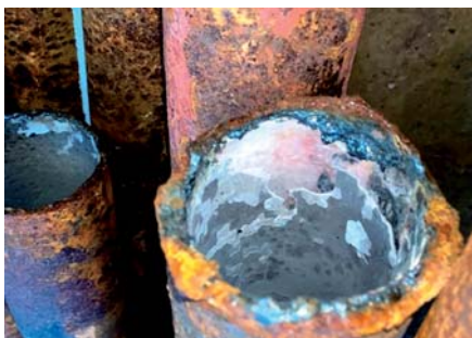
Накипь в экранных трубах энергетических котлов
