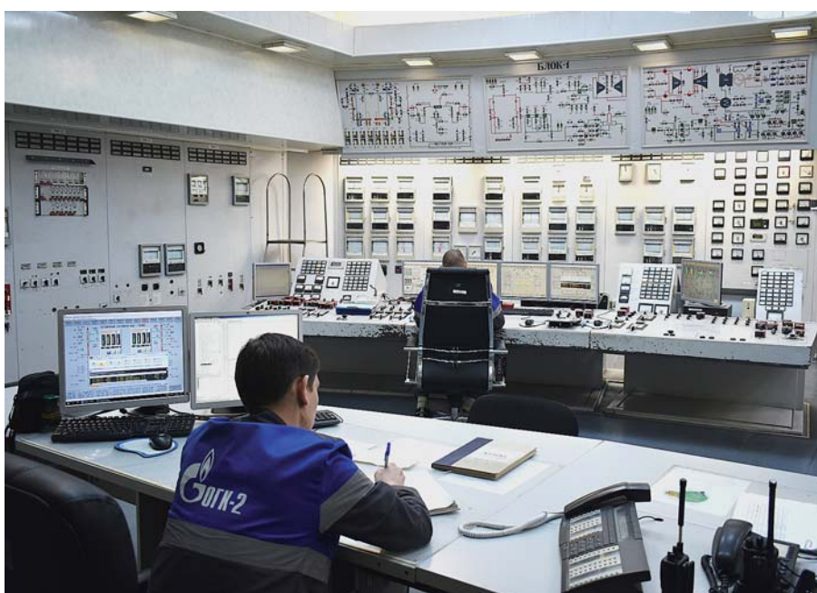
На блочном щите управления
