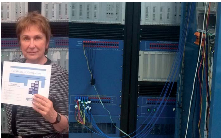
Начало работы комплекса RTDS на кафедре релейной защиты и автоматизации энергосистем. К этому времени Т. Г. Климова получила допуск к работе от фирмы-производителя
